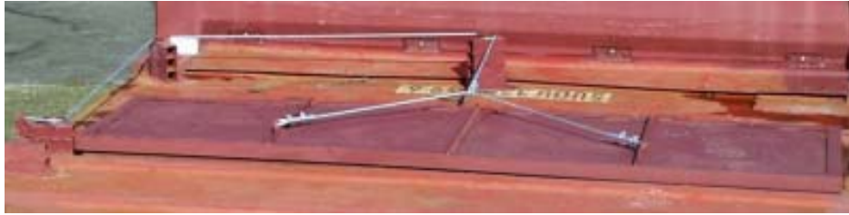
Abbildung 1.4.2: geschlossene Ventilationsklappe (RWA) (Nds. LFS Celle)
