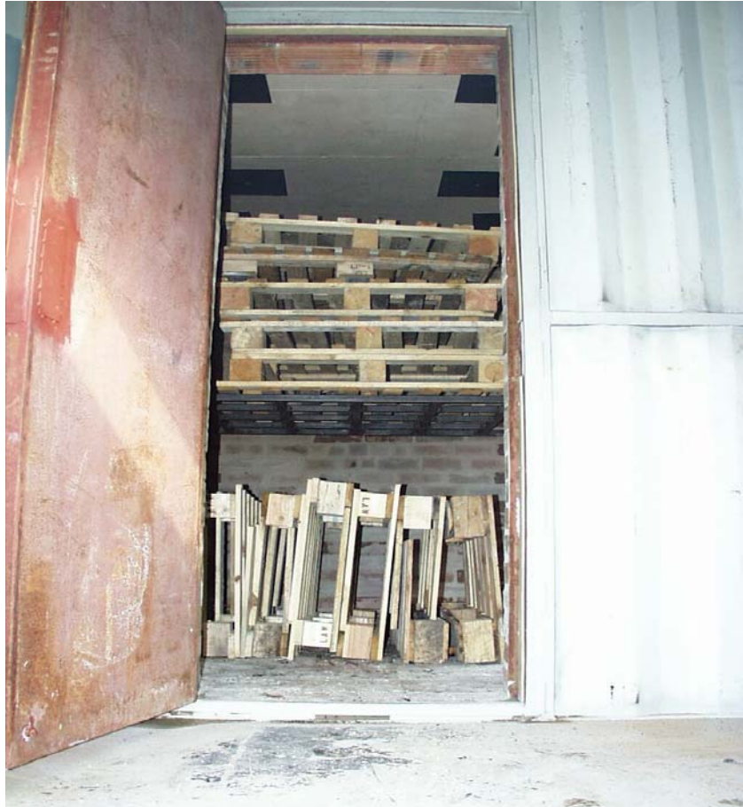
Abbildung 1.2.3: Aufnahmegestell für Paletten mit der geöffneten Bandraumtür (Nds. LFS Celle)
